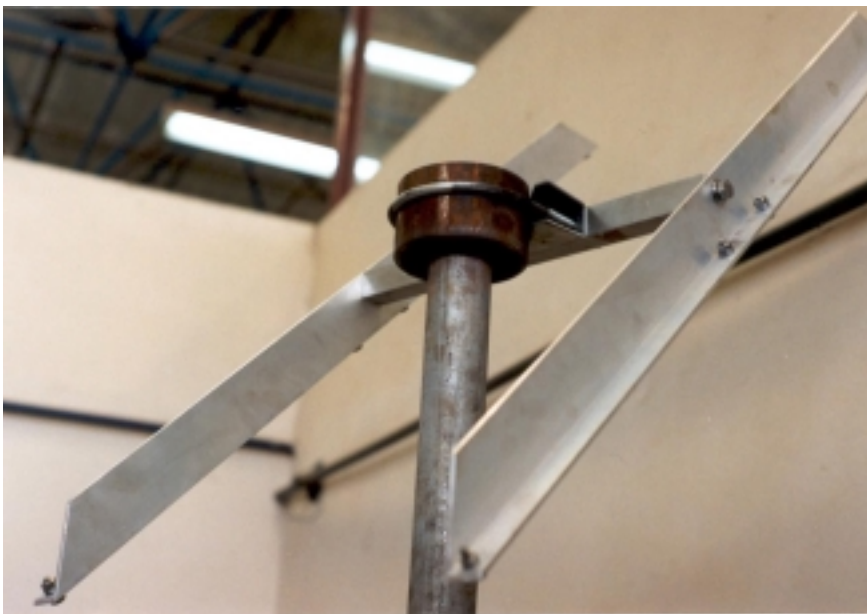
Foto 67 – Suporte do painel solar fixado na haste.
