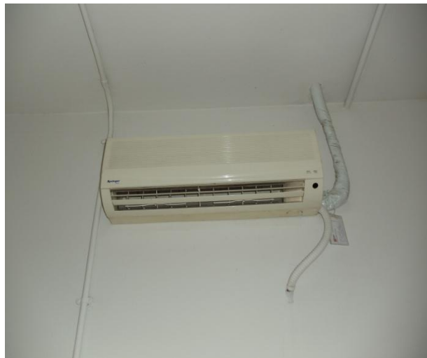
Figura 5: Aparelho de ar condicionado, modelo split, da Sala de Fonoaudiologia Fonte: Do pesquisador
