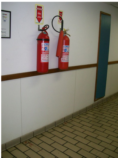
Ausência de sinalização da Área dos extintores
