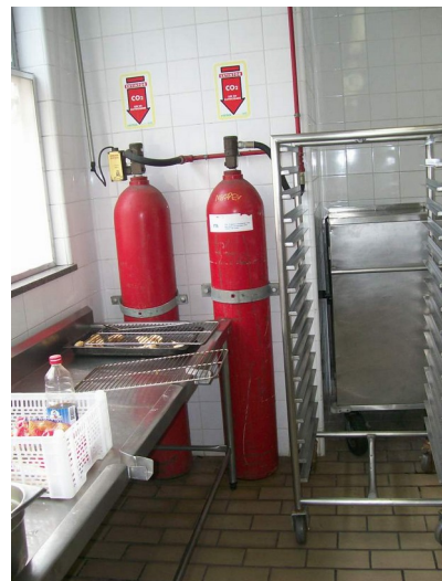
Obstrução da área reservada aos extintores
