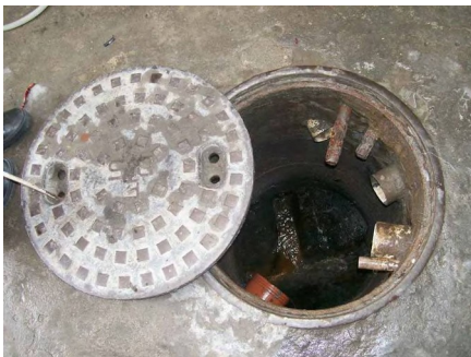
Foto 6 – bueiro de anel (refluxo do esgoto)
