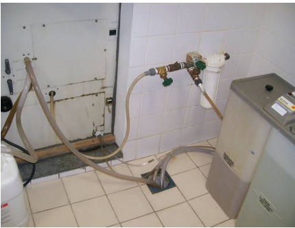
Foto 3 – despejo do revelador diretamente na rede de esgoto
