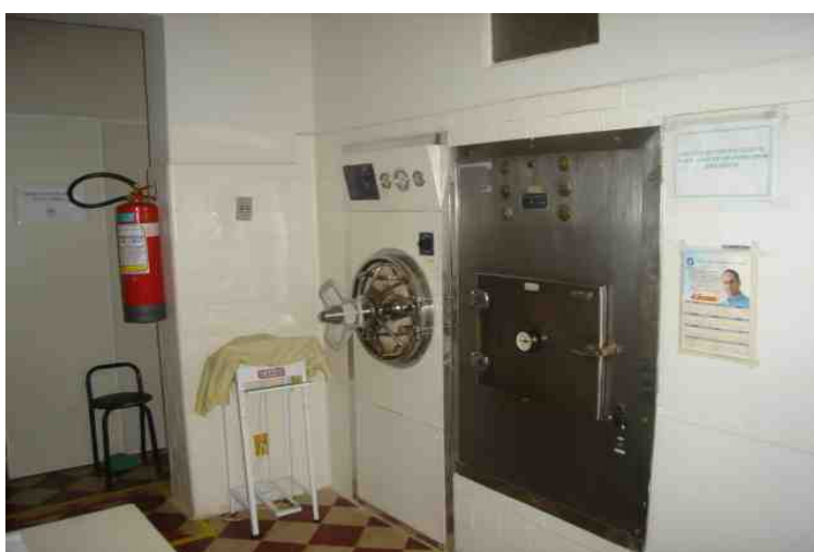
Central de esterilização
