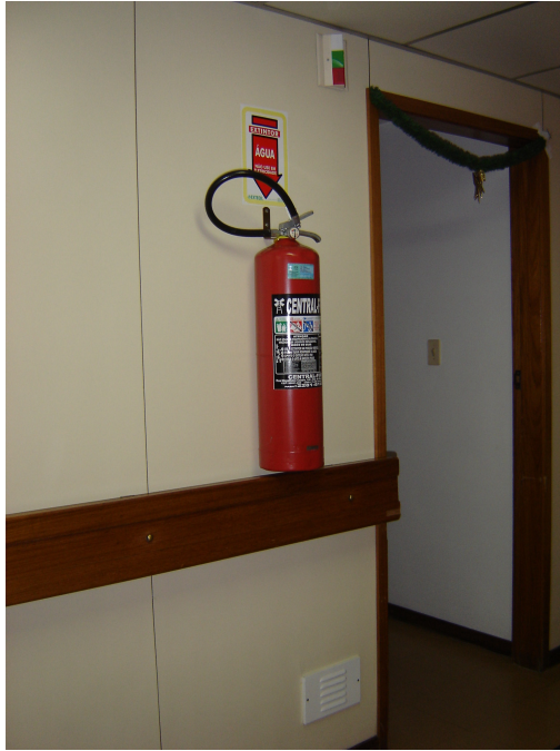
Figura 14 – Sinalização indicando o extintor de incêndios
